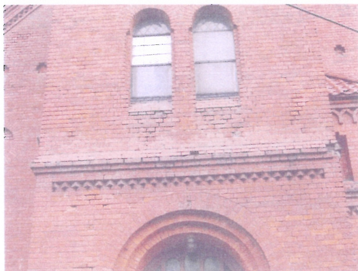
FOT.3.ELEWACJA ZACHODNIA, OSYPUJĄCA SIĘ SPOINA, ZNISZCZONE LICO CEGIEŁ
