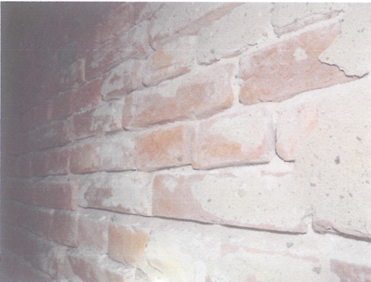
FOT.41. WIEŻA, ZNISZCZENIA SPOIN I CEGIEŁ
