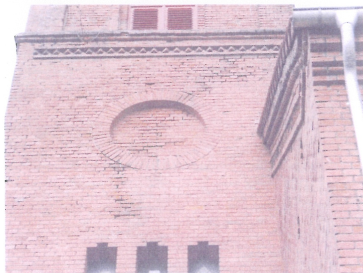
FOT.26.ELEWACJA POŁUDNIOWA, USZKODZENIA CEGIEŁ I SPOIN
