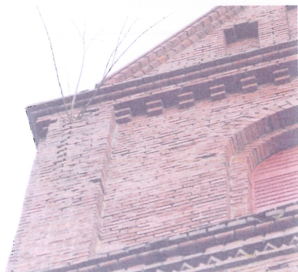
FOT.4.ELEWACJA ZACHODNIA, OSYPUJĄCA SIĘ SPOINA, ZNISZCZONE LICO CEGIEŁ, ROŚLINNOŚĆ
