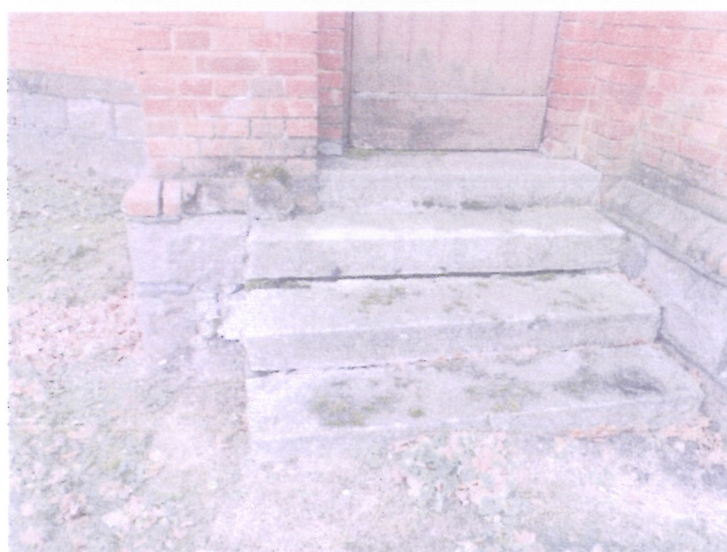
FOT.14.ELEWACJA PÓLNOCNA, SCHODY GRANITOWE DO NAPRAWY
