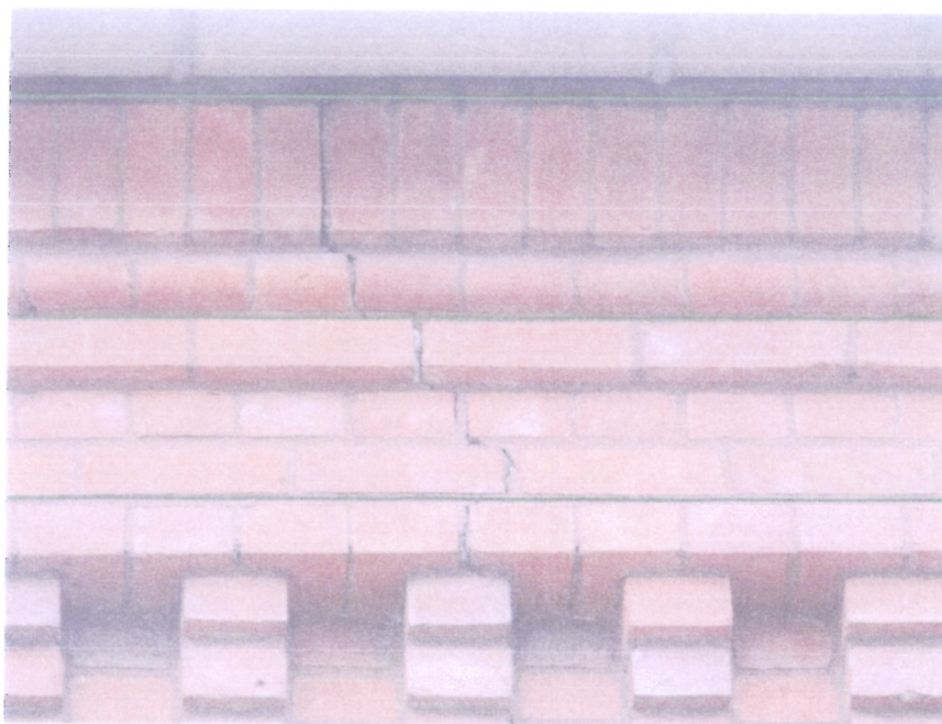
SPIĘCIE ZARYSOWAŃ Z FOT.17.
