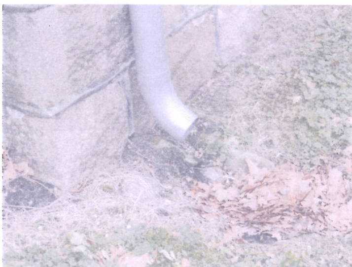
FOT.16.ELEWACJA PÓŁNOCNA, WODA DESZCZOWA ODPROWADZONA ZBYT BLISKO KOŚCIOŁA
