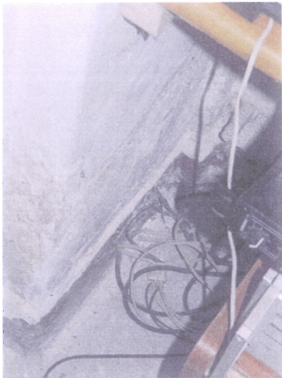
FOT.43. ZAWILGOCENIA ŚCIAN W ANEKSIE BOCZNYM
