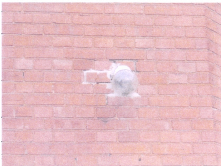
FOT.29.ELEWACJA POŁUDNIOWA, LAMPA DO WYMIANY LUB LIKWIDACJI
