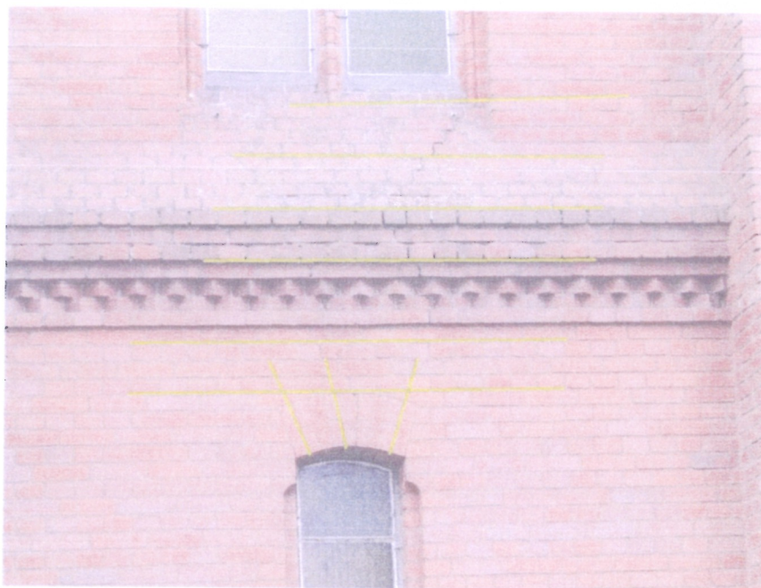
SPIĘCIE ZARYSOWAŃ Z FOT.19.
