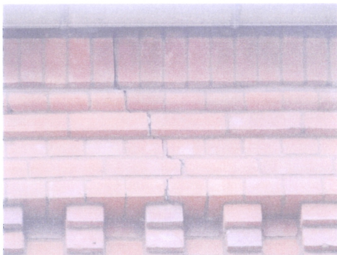
FOT.17.ELEWACJA PÓLNOČNA, ZARYSOWANIE GZYMSU
