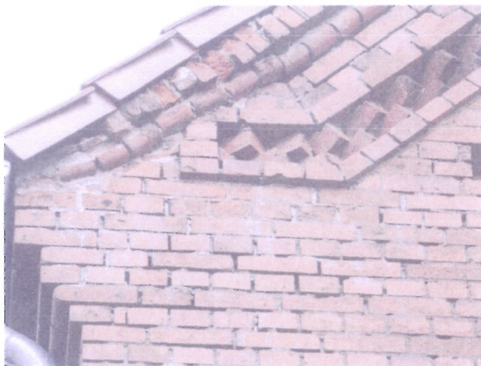
FOT.2.ELEWACJA ZACHODNIA, OSYPUJĄCA SIĘ SPOINA, ZNISZCZONE LICO CEGIEŁ
