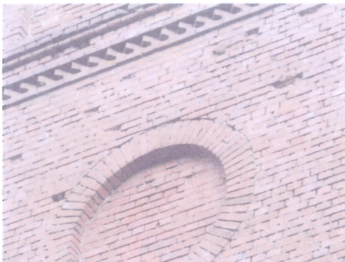
FOT.5.ELEWACJA ZACHODNIA, OSYPUJĄCA SIĘ SPOINA, ZNISZCZONE LICO CEGIEŁ
