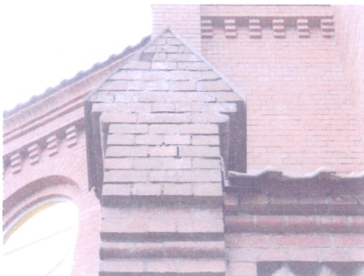
FOT.15.ELEWACJA PÓŁNOCNA, ZASOLENIA CEGIEŁ I UBYTKI SPOIN
