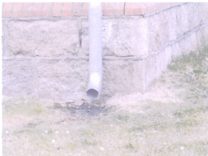
FOT.20.ELEWACJA PÓLNOCNA, , WODA DESZCZOWA ODPROWADZONA ZBYT BLISKO KOŚCIOŁA
