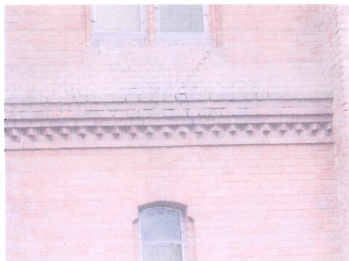
FOT.19.ELEWACJA PÓLNOČNA, ZARYSOWANIE ŚCIANY
