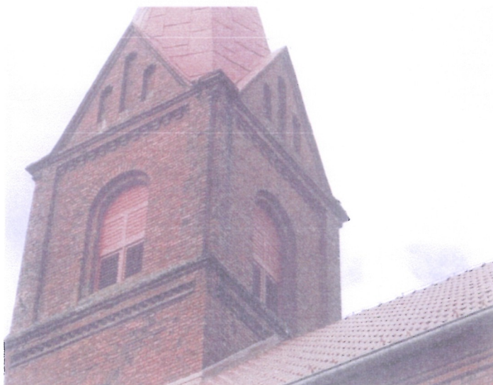
FOT.11.ELEWACJA WSCHODNIA, USZKODZENIA CEGIEŁ I SPIONOWANIA
