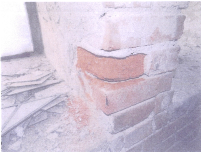
FOT.33. WIEŻA, POZIOM II, SILNE ZNISZCZENIA CEGIEŁ
