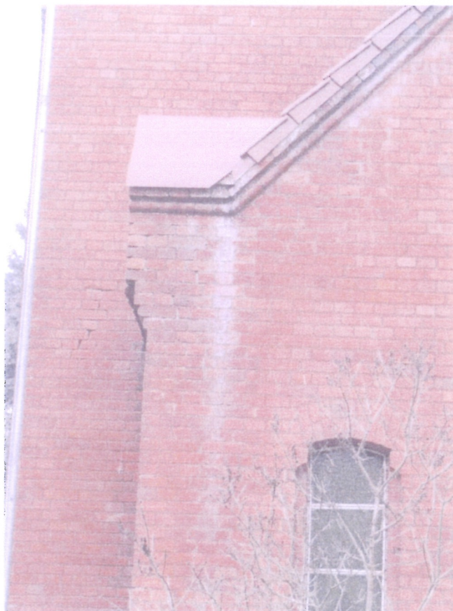
FOT.9.ELEWACJA WSCHODNIA, WYSOLENIA
