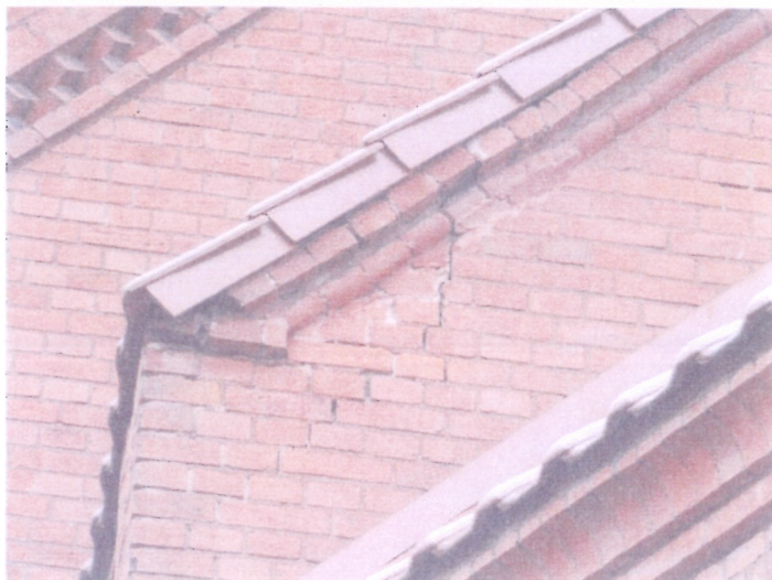
FOT.10.ELWACJA WSCHODNIA, ZARYSOWANIA
