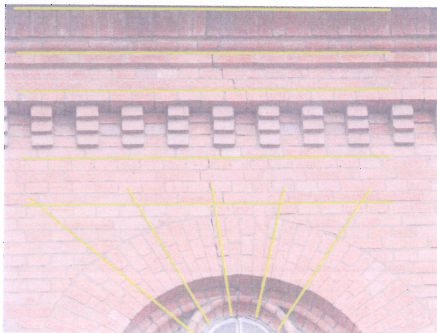
SPIĘCIE ZARYSOWAŃ Z FOT.18.
