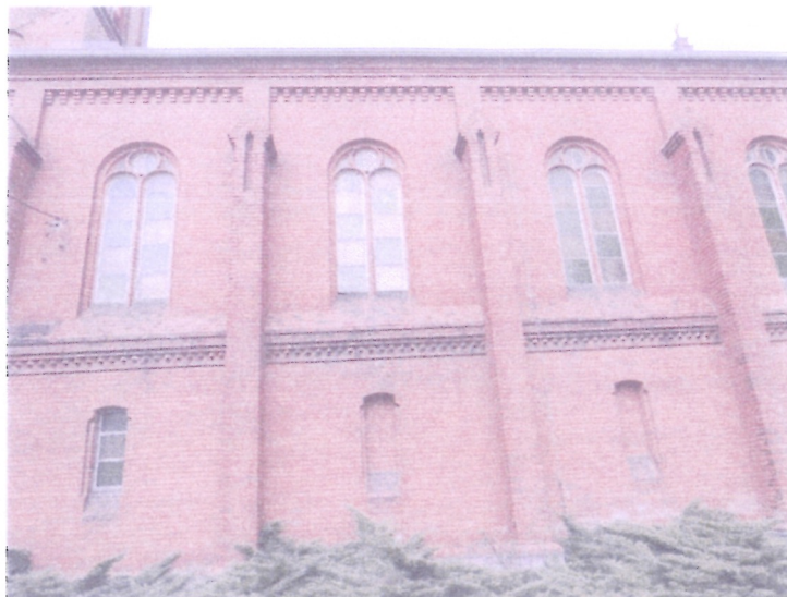
FOT.27.ELEWACJA POŁUDNIOWA, ZAWILGOCENIA STREF PARAPETÓW
