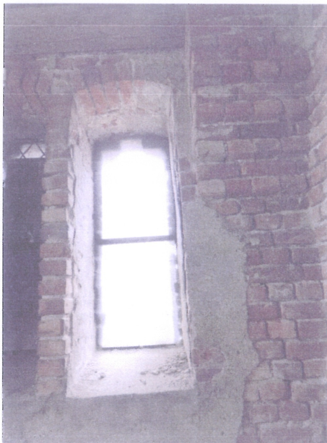
FOT.34. WIEŻA, POZIOM III, USZKODZENIA SPOIN I CEGIEŁ NA DUŻEJ POWIERZCHNI
