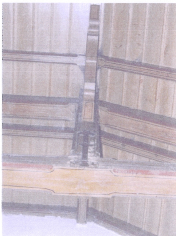
FOT.31. WNETRZE KOŚCIOŁA, ZNISZCZONE FRAGMENTY KONSTRUKCJI STROPU
