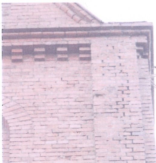
FOT.23.ELEWACJA PÓLNOCNNA, USZKODZENIA CEGIEŁ I SPOIN, ROŚLINNOŚĆ NA MURACH
