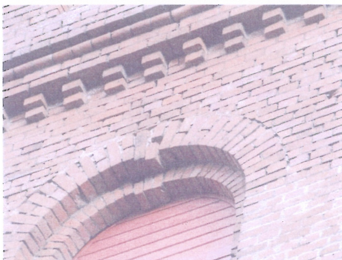
FOT.6.ELEWACJA ZACHODNIA, USZKODZONE NADPROŻE
