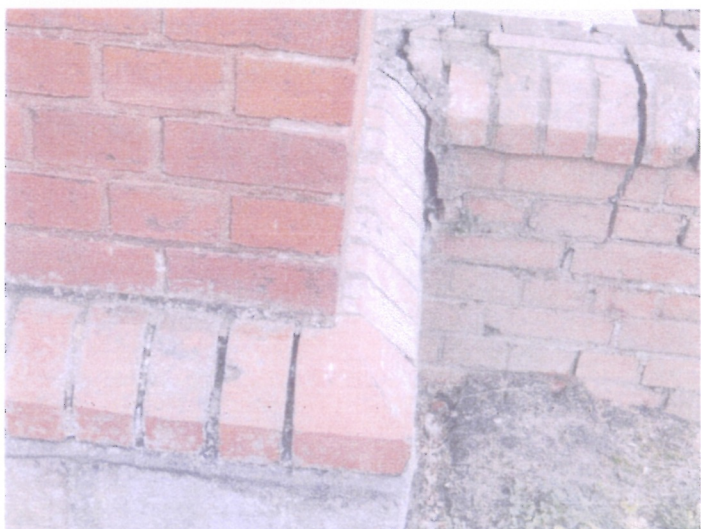
FOT.8.ELEWACJA WSCHODNIA, USZKODZONY MUREK
