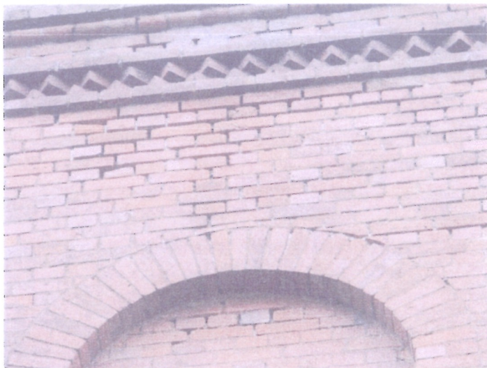
FOT.22.ELEWACJA PÓLNOCNNA, USZKODZENIA CEGIEŁ I SPOIN
