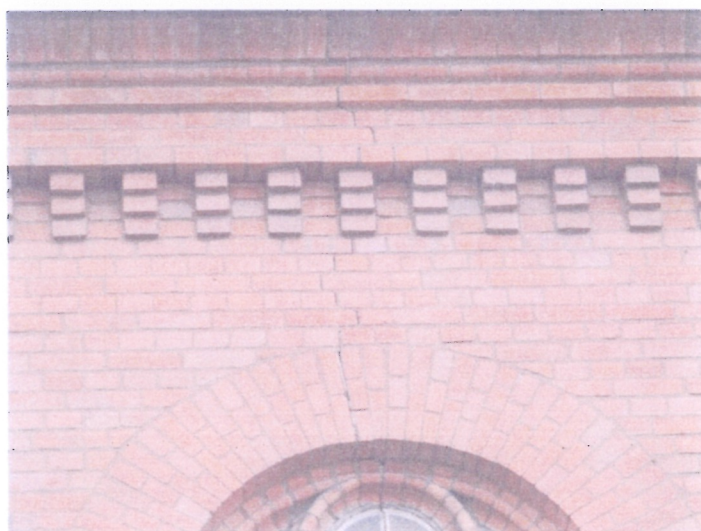
FOT.18.ELEWACJA PÓLNOČNA, ZARYSOWANIE ŚCIANY
