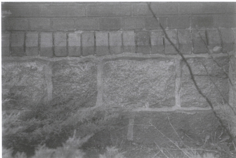
Fot. 18 Silna cementowa spoina pomiędzy blokami granitowymi.
