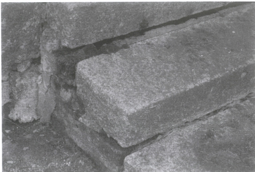
Fot. 10 Schody granitowe do kościoła od strony północnej. Silnie uszkodzone i porażone biologicznie.
