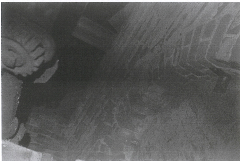
Fot. 23 Uszkodzona wyprawa tynkarska. Odślonięte lico cegieł. Spoina wykruszona, osypująca się.
