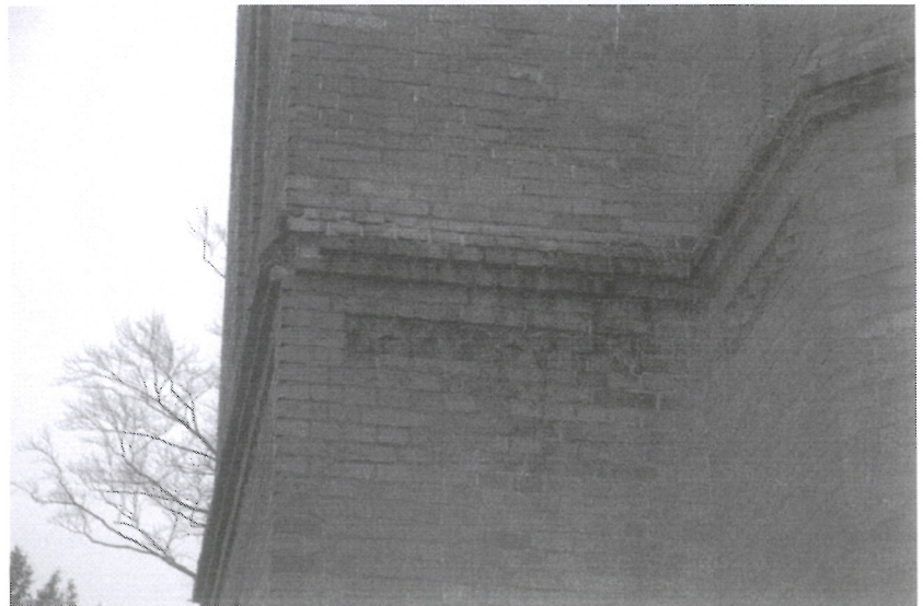
Fot. 13 Czarne smółkowe zanieczyszczenia na elewacja.
