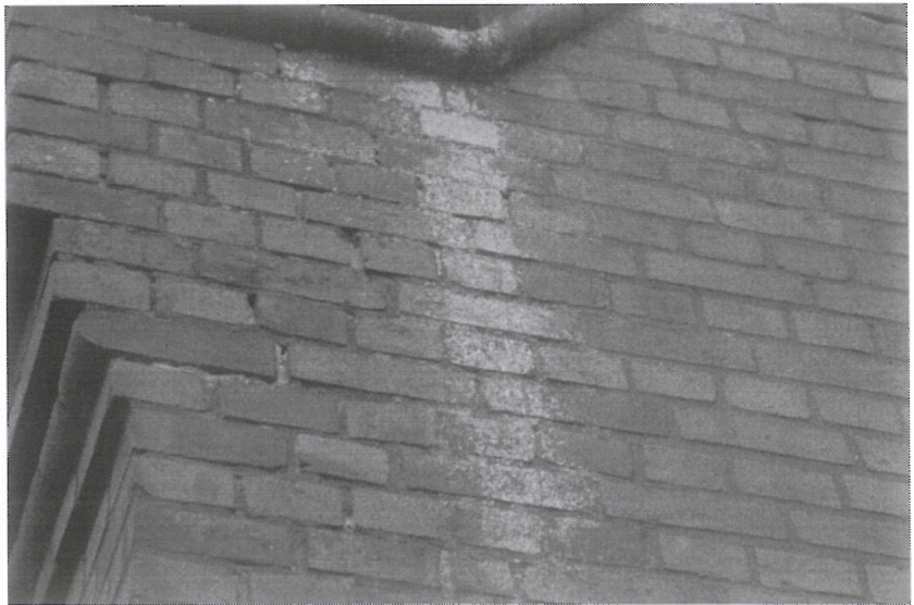
Fot. 7. Porażona biologicznie elewacja, uszkodzona spoina na skutek wietrzenia i działania wód opadowych.
