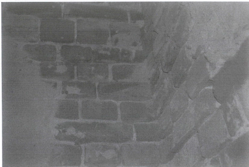
Fot. 22 Uszkodzona wyprawa tynkarska. Odślonięte lico cegieł. Spoina wykruszona, osypująca się.
