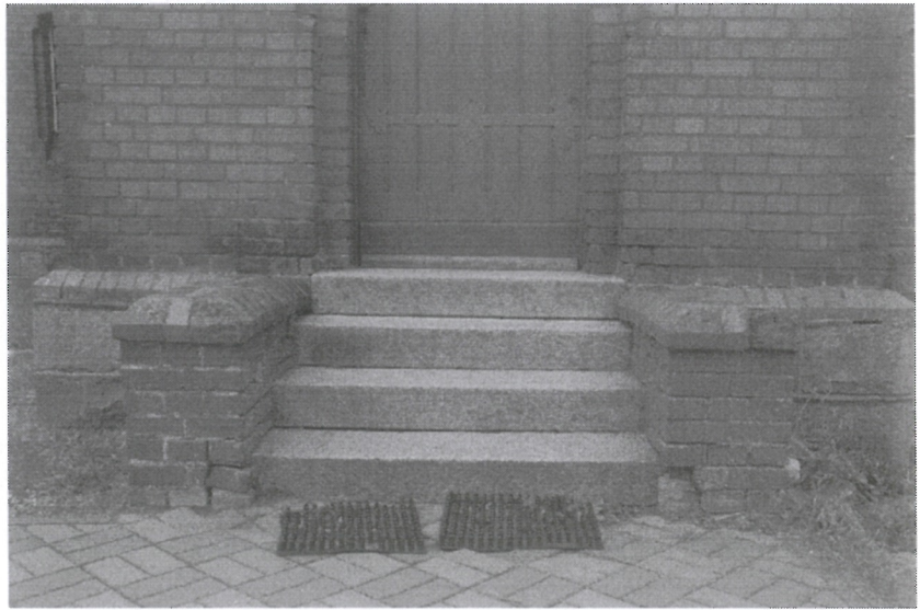
Fot. 9 Schody pozbawione spoiny, ceglane słupki silnie uszkodzone i porażone biologicznie.
