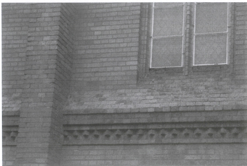
Fot. 11 Czarne smółkowe zanieczyszczenia na elewacji. Uszkodzona spoina na przyporach i parapetach.
