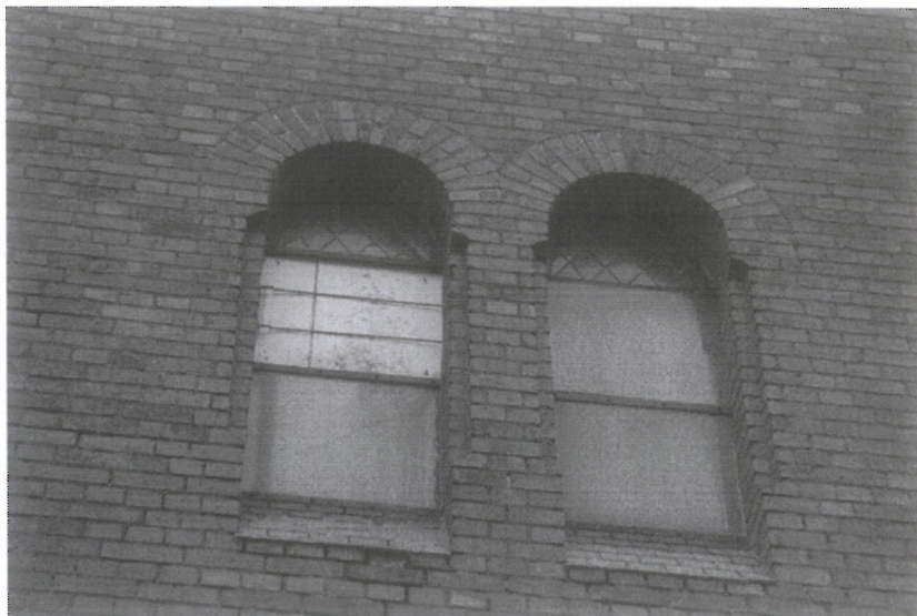
Fot. 14 Uszkodzone lico cegieł, w wielu miejscach spoina uszkodzona lub całkowicie wyłukana. Niedopasowane szklenie okien.
