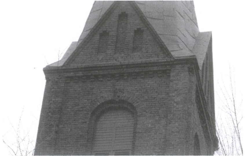
Fot. 12 Osunięte cegły w łuku. Silnie uszkodzona spoina. Na narożniku północno zachodnim samosiew drzewa.
