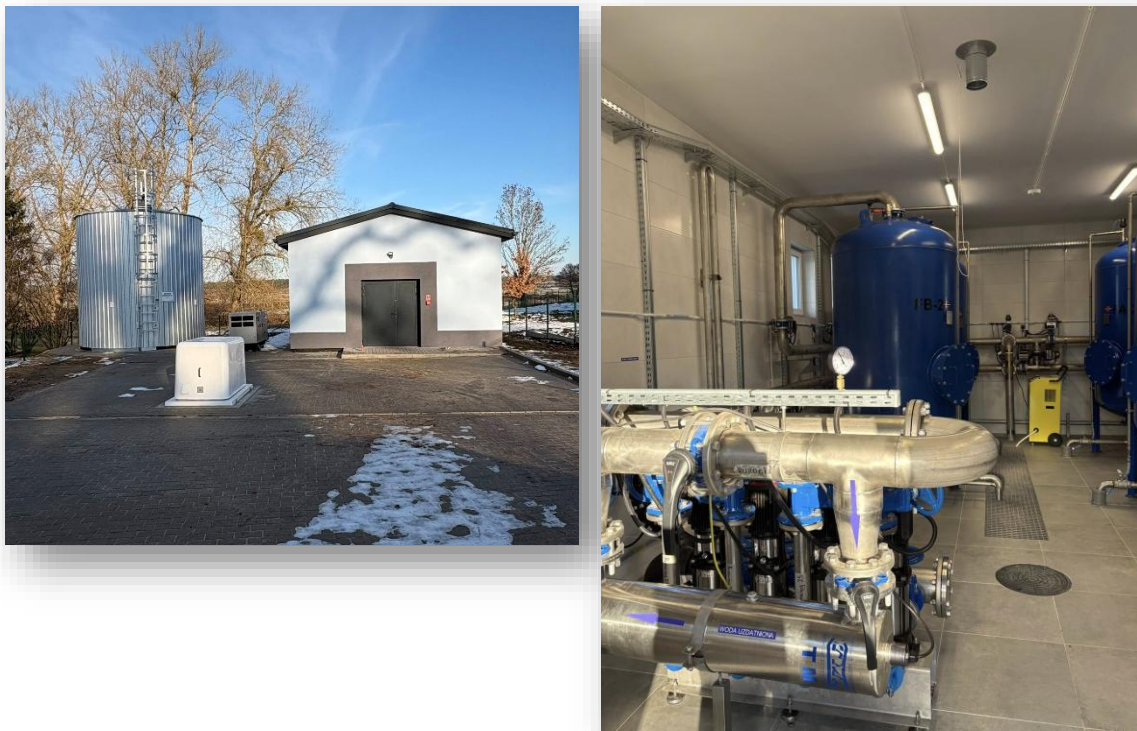
Zdjęcie 8 Stacja uzdatniania wody w Zegrzu Pomorskim
