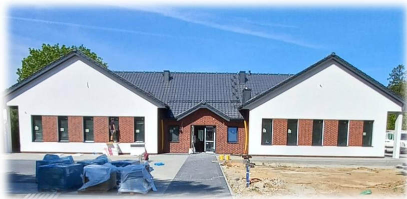
Zdjęcie 11 Budowa świetlicy wiejskiej z filią biblioteki publicznej oraz remizą Ochotniczej Straży Pożarnej
